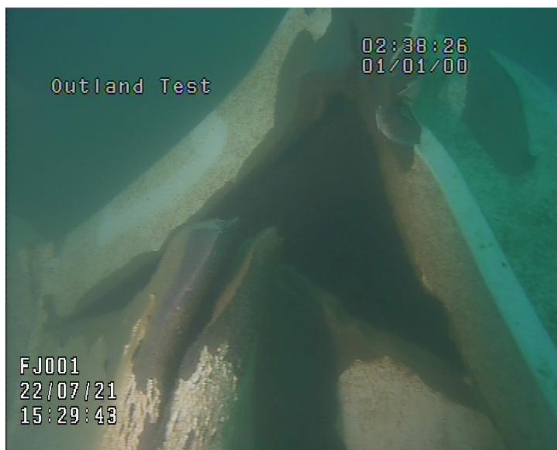
图 9.主吊机结构破损图片
